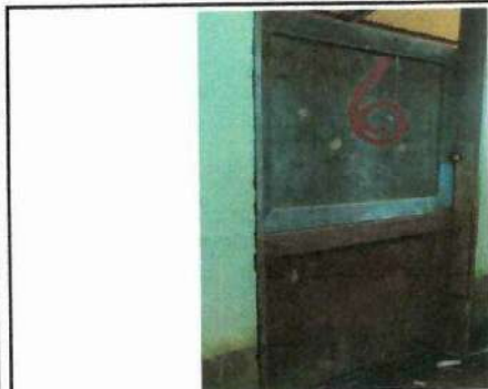
Foto 3: Se observa el deterioro de la puerta portante del modulo 2.
