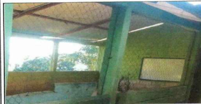
Foto 5: Se observa el deterioro de las mallas del aula portante del modulo 2.
